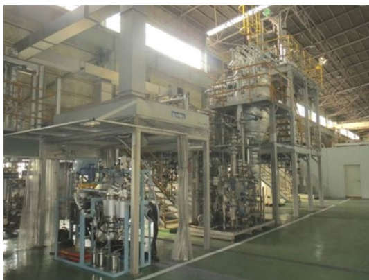
図5 バイオマスガス化-FT 合成一貫試験設備
