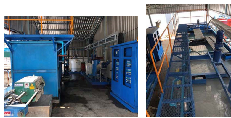
図2 排水処理装置
