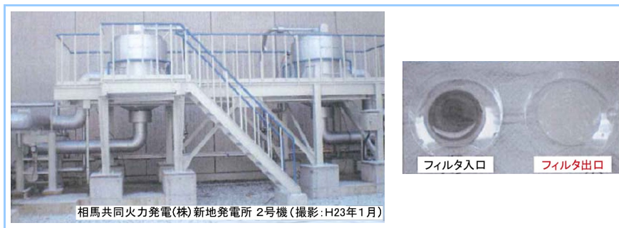
図6 低压給水加熱器ドレン系統鉄除去装置の外観
