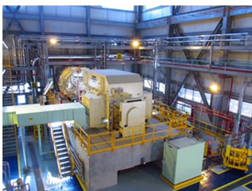
図3 ロス・アズプレス向け 軸流排気タービン・発電機
