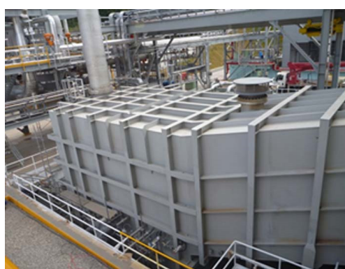
図4 ロス・アズプレス向け 直接接触式復水器
