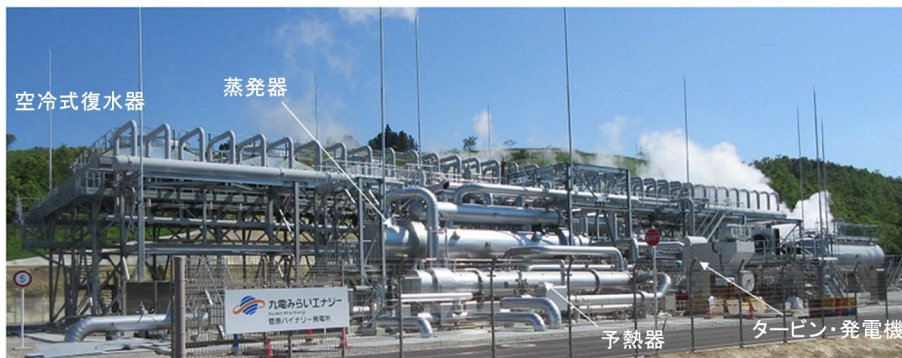
図2 バイナリー発電システム概観
