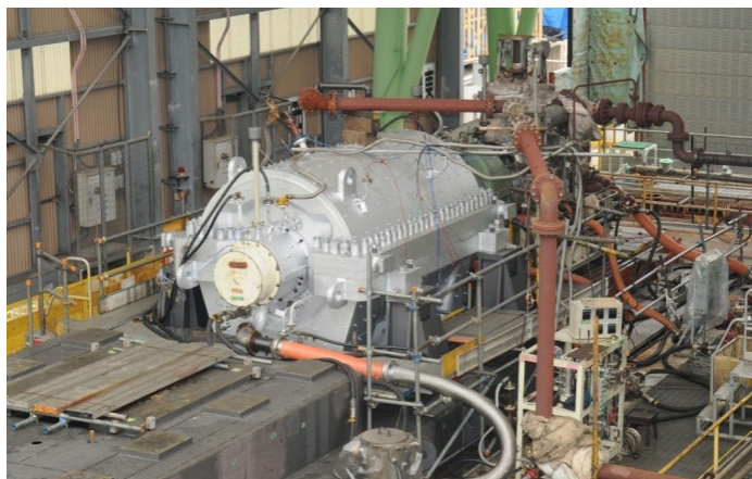
図1 プロパン冷凍圧縮機の工場性能試験
