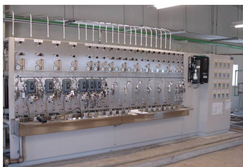
図4 サンプルング装置の外観(5号発電所)
