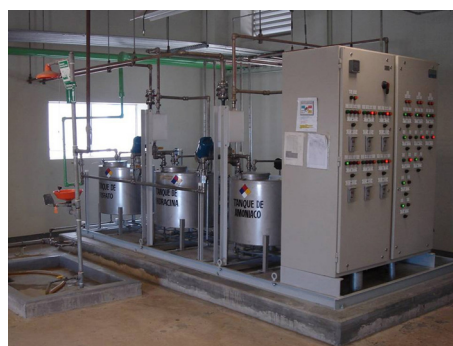
図5 薬品注入装置の外観(5号発電所)
