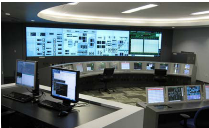
図2 新型中央制御盤検証設備
