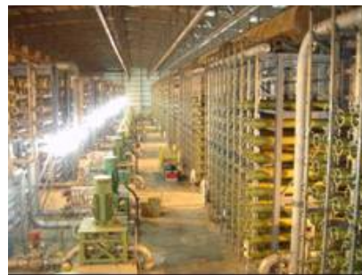
図2 第2段 & 第3段の低圧 RO 膜 高脱塩性能を有するポリアミド製スパイラル膜を採用。
