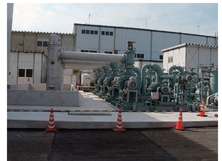
図3 真空ポンプ 燃焼試験設備で使用している大容量真空ポンプの外観を示す。
