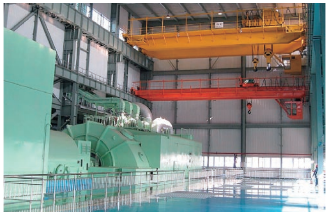
図2 タービフロア配置 手前からガスタービン、発電機、蒸気タービン、燃料ガス圧縮機が一軸に結合されている。
