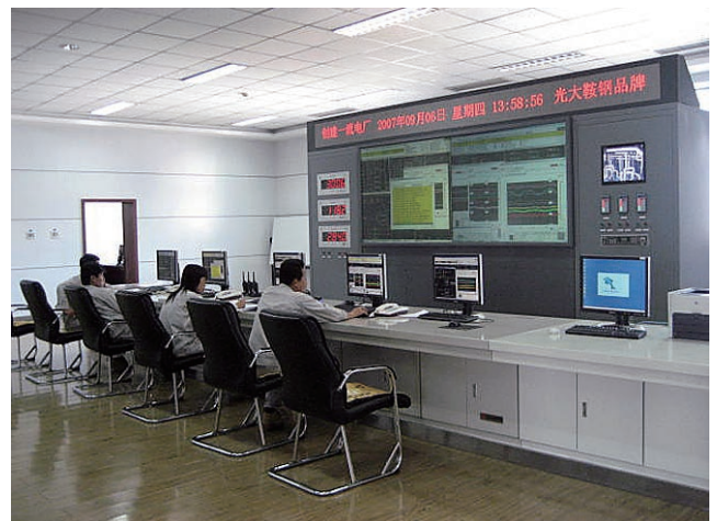
図7 中央操作室(4F) 手前にOPSのデスク盤、奥に2面の大型スクリーンを設置している。
