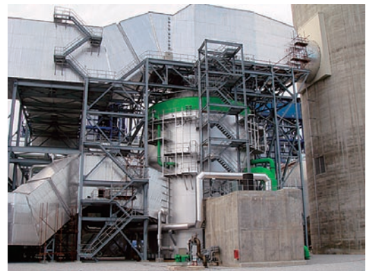
図7 海水式脱硫設備(吸収塔)
