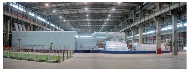
図5 川崎火力発電所1号系列第3軸M701G2ガスタービン初号機は東京電力(株)川崎火力発電所1号系列第3軸に設置され、順調に試運転を完了させた後、2007年6月に運開した。
