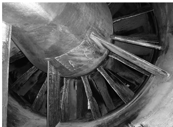
図9 約18000時間運転後の動翼外観状況 約2年半運転後の現地でのFRP動翼の外観を示す。
