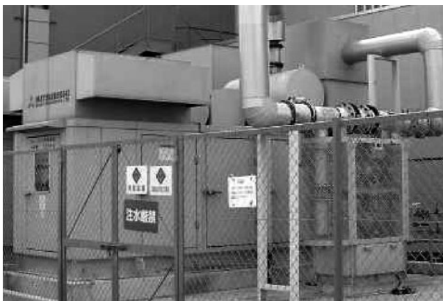
図12 黒煙除去装置設置状況 高硫黄燃料においても黒煙を除去できる。
