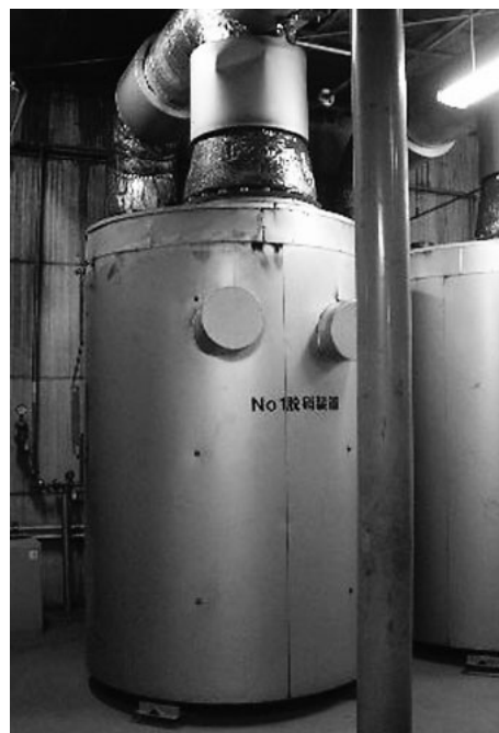
図10 当社の自家発電プラント用脱硝装置 脱硝率は90%を超える。
