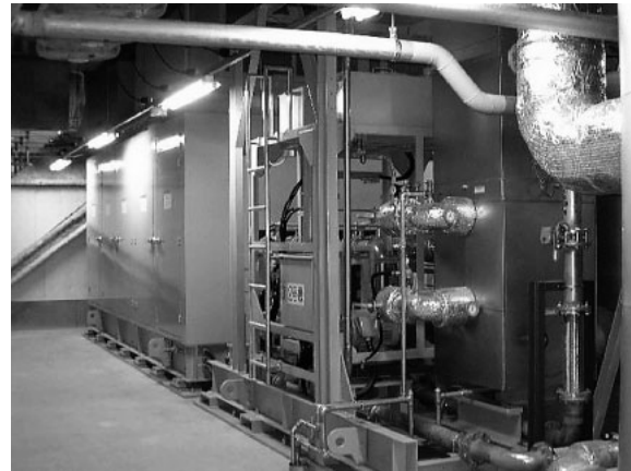
図6 稼働中のGS12R-M ミラーサイクルの適用により従来に比較し大幅な熱効率改善を達成している。
