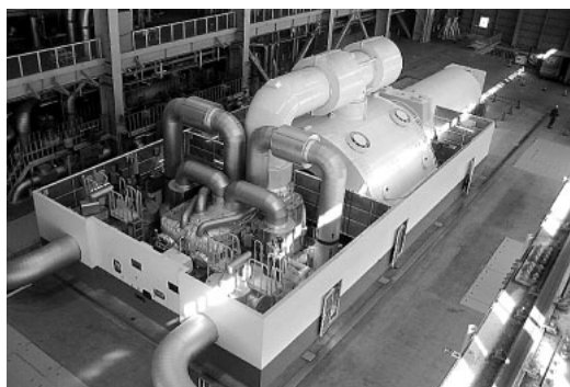
図1 広野5号機600 MW蒸気タービン外観
