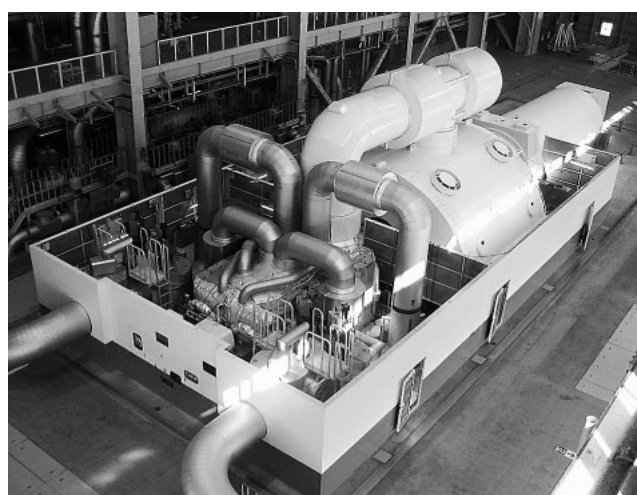
東京電力(株)広野火力発電所 5号機 600 MW 石炭火力 当社は蒸気タービン・ボイラ・排煙脱硫設備・制御装置・煙突を納入(上段) 600 MW 蒸気タービン 二車室構造の世界最大容量機(下段)
