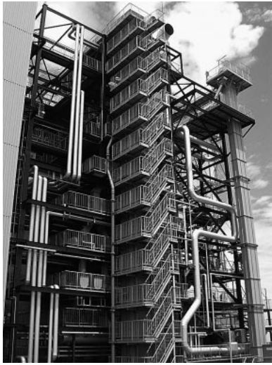
三菱製紙(株)八戸工場 廃タイヤ・木屑・スラッジ等廃棄物焚き流動床ボイラ
