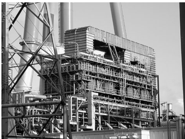
図7 鹿島北共同発電(株)3号排脱設備概観
