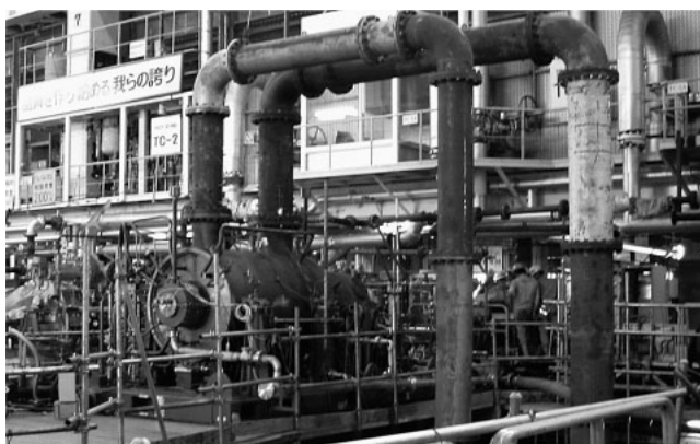
図9 2500トン/日メタノールプラント用圧縮機工場立会試験 2500トン/日プラント用圧縮機の工場試験風景を示す。
