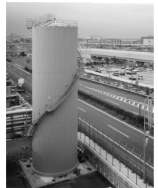
図14 新東京国際空港（成田空港）に設置したPCM蓄熱システム
