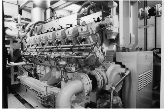
図6 ミラーサイクルガスエンジン外観 図5のS16Rエンジンをコージェネ用ミラーサイクルガスエンジン化したGS16Rの設置状況を示す。
