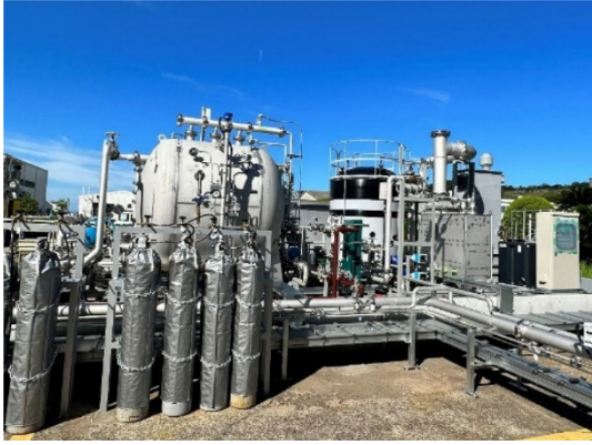
図9 アンモニアハンドリング実証試験設備
