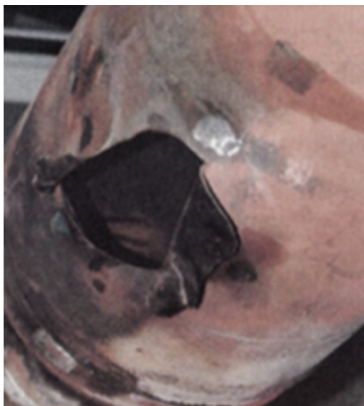
図1 プラント配管の損傷事例 (FAC:Flow Accelerated Corrosion: 流れ加速腐食)
