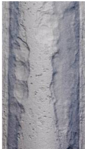
図2 ボイラ伝熱管の損傷事例 (硫化腐食:表面スケール除去後)
