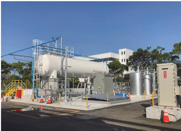
図4 アンモニア供給設備外観
