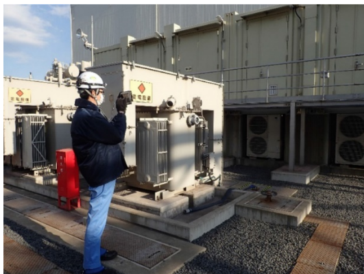
図8 発電プラントにおけるスマート巡回点検システムの試行状況
