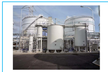
図7 高速凝集沈殿設備
