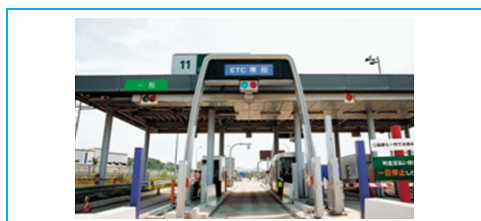
図2 ノンストップ自動料金支払いシステム 5.8GHz 帯のアクティブ方式 DSRC*を利用して、車両情報を無線通信し料金収受を行うシステム *DSRC: Dedicated Short Range Communications
