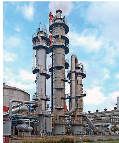
図3 国内一般用途向け CO 2 回収プラント
