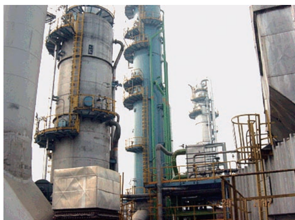
図5 インド尿素生産設備向け CO 2 回収プラント
