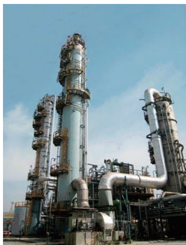
図4 インド尿素生産設備向け CO 2 回収プラント
