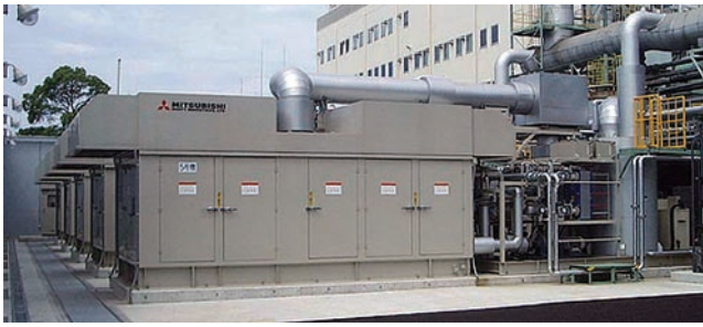
図4 稼動中のアドバンスミラー GS16R-815kW 蒸気+温水回収仕様
