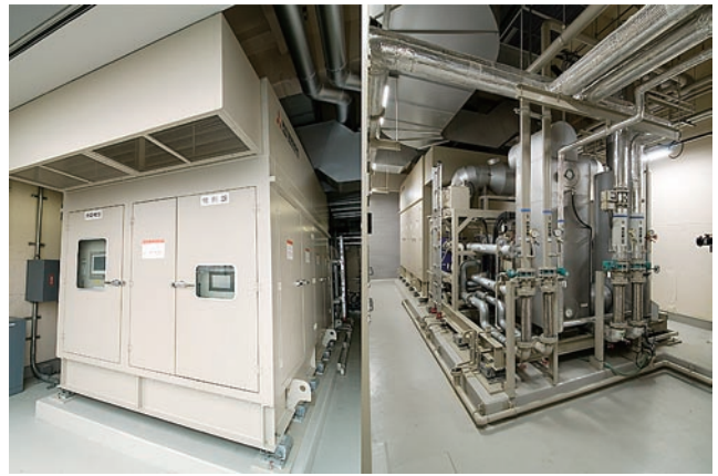
図6 稼動中のアドバンスミラー GS6R-305kW 温水回収仕様
