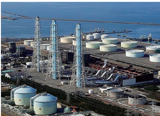
図 1 G 形コンバインドサイクルプラント 東北電力(株)東新潟火力発電所第 4-2 号系列。
