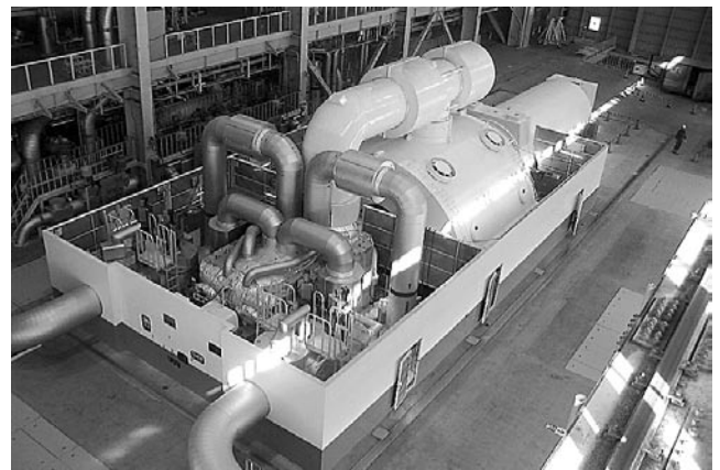
図2 広野5号機タービン外観
