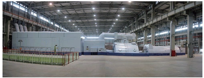
図7 1500℃ 級 GTCC プラント (東京電力(株)川崎火力発電所 1 号系列) 最新の G 型ガスタービンを採用した高効率発電プラント。
