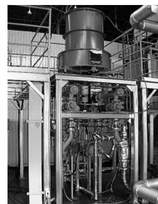
図3 バイオマス連続計量供給試験装置 計量払出からインジェクタで搬送する。
