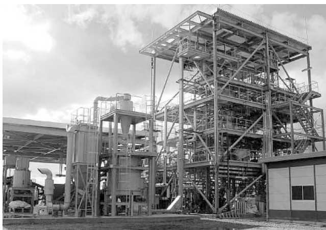
バイオマス処理量 2t / 日規模試験装置 (中部電力川越火力発電所内) 各種木質バイオマスからメタノールの製造が可能
