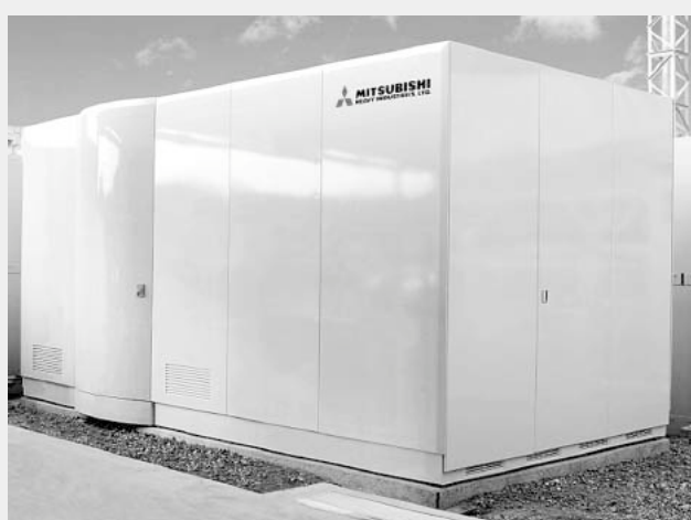
40 kW 級 SOFC コージェネレーションシステム 愛知万博 NEDO 新エネプラントのマイクログリッド電源 の一つとして出展
