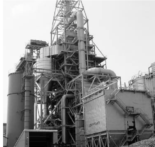
王子板紙(株)大分工場 RPF (Refuse Paper and Plastic Fuel) 焼き循環流動層ボイラ
