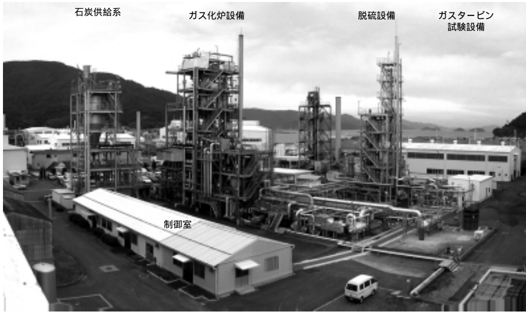
図3 一貫試験設備外観
