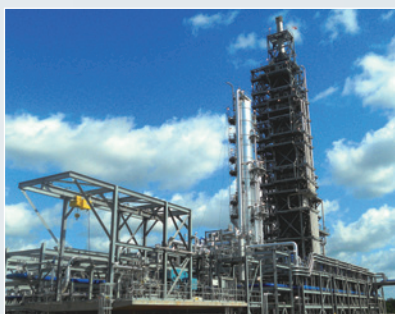
CO 2 回収プラント
