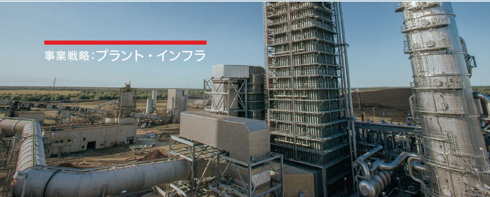
CO 2 回収プラント(米国)
