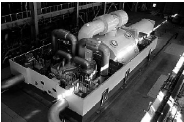
図5 広野5号機600 W蒸気タービン外観
